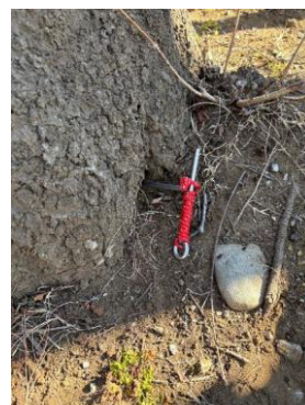
【写真-6】根元 開口空洞
